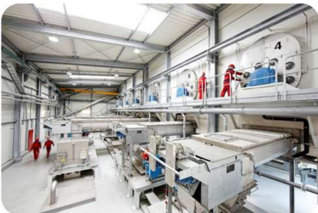
Abb. 5.2-5: Pressen trennen das Prozesswasser von den festen Abfallbestandteilen
