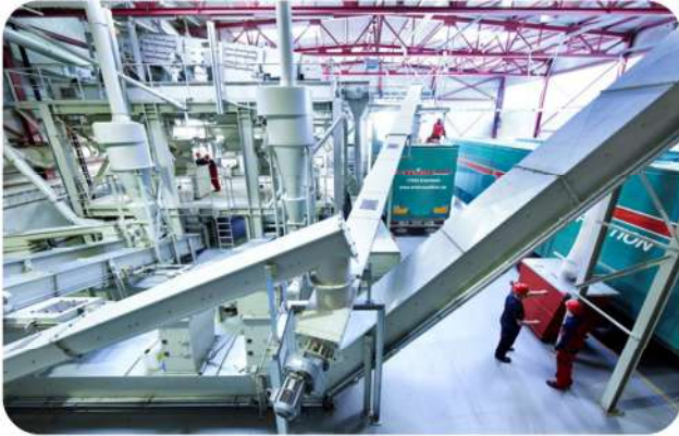
Abb. 5.2-8: Aggregate zur Trennung von schweren und leichten Bestandteilen
